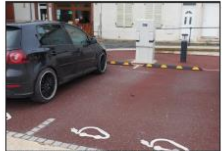
Une borne électrique installée place de l'hôtel de ville.
