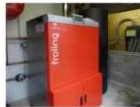
La nouvelle chaudière à pellets dans sa chaufferie nouvellement construite. Photo ER
