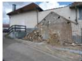
Emplacement de l'ancienne et de la nouvelle chaufferie accueillant la nouvelle chaudière à pellets. Photo ER
