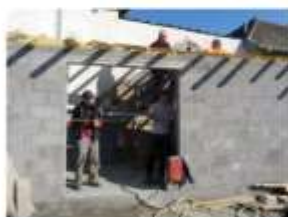
La nouvelle chaufferie construite par Partégo Soléfor de Blamont à la place de l'ancienne plu du tout adapté. Photo ER
