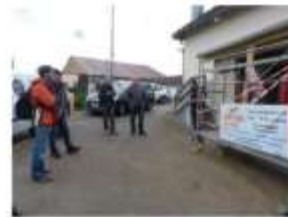
Mise en service de la chaudière par l'entreprise Martin Thiery de Baccarat installateur du silo et de la chaudière à pellets. Photo ER
